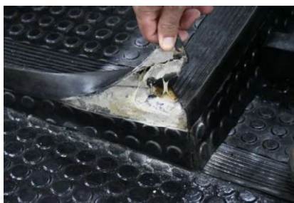
Descolamento do piso
