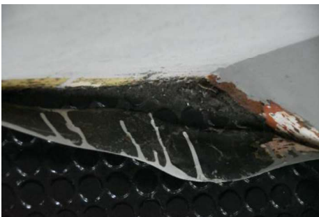
Descolamento do rodapé
